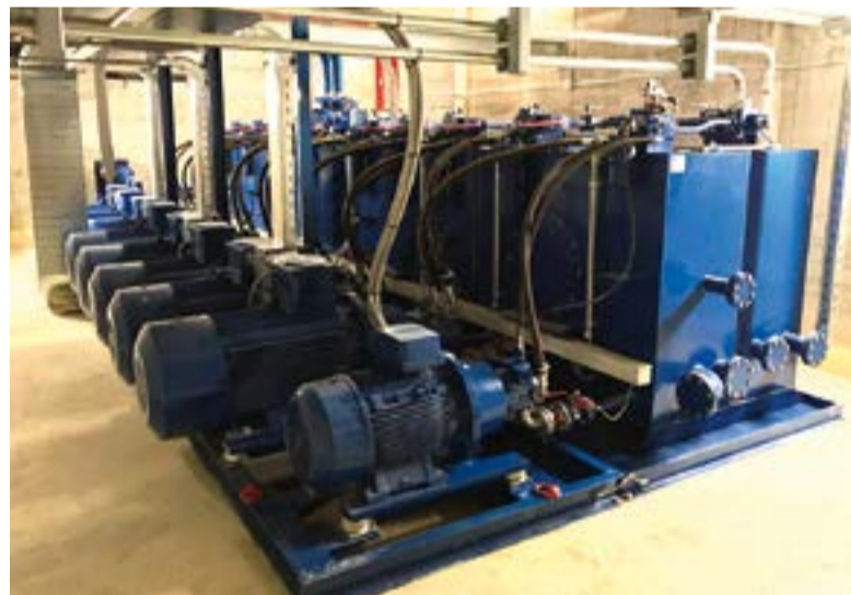
FIGURA 2. Centro di Ricerca L.E.D.A.: Centrale idraulica di potenza.
