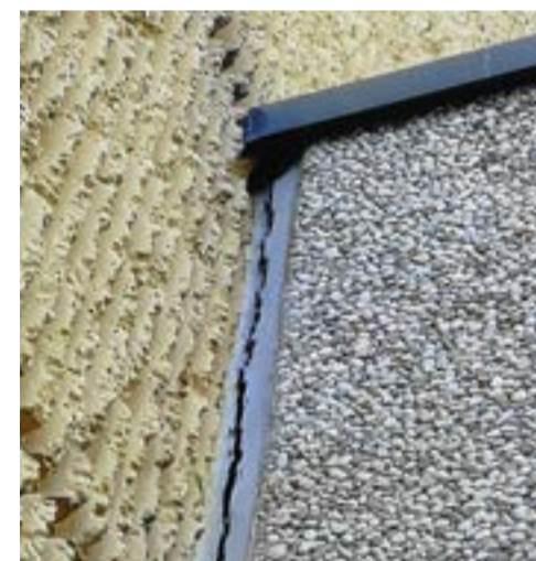
Foto 7. Contatto veletta-palazzina uffici (capannone 1). Il silicone è fessurato e si percepisce anche la rotazione della veletta.
