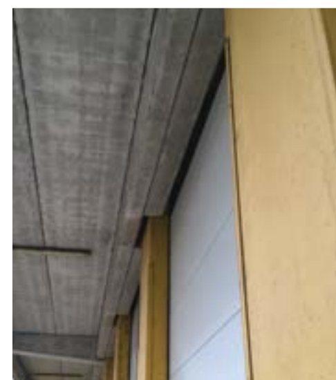
Foto 8. La pensilina dall'esterno (capannone 2). Si nota il distacco dai pilastri secondari (rimasti verticali)
