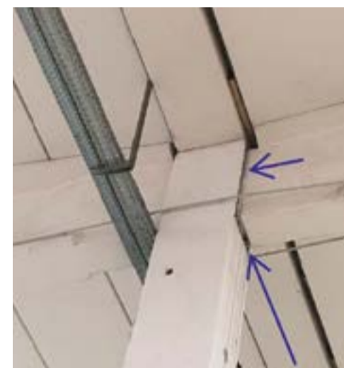
Foto 6. Un appoggio interno (capannone 2). Si nota la porzione di neoprene fuoriuscente e la diversa colorazione della trave
