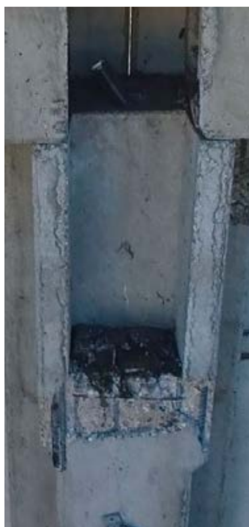
Foto 2. Capitellos con crosta di cls che ha ceduto
