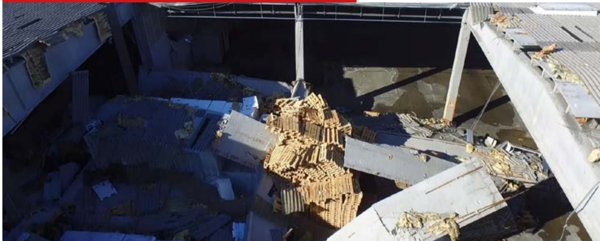
Foto 1. La porzione di copertura crollata
