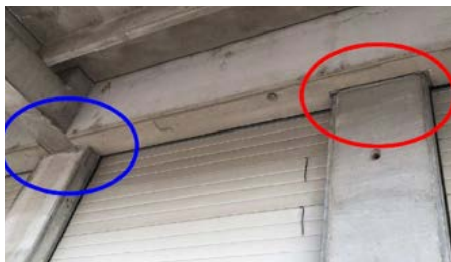
Foto 5. La pensilina dall'esterno (capannone 1). Si nota il silicone fessurato in corrispondenza dei pilastri secondari rimasti verticali (ovale rosso), e l'attacco della mensola al pilastro dove il silicone è integro (ovale blu)
