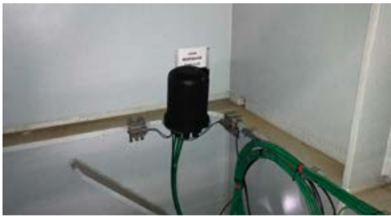
Accelerometri per monitoraggio dinamico e vibrazionale dell'impalcato metallico (immagine fornita da CETENA).
