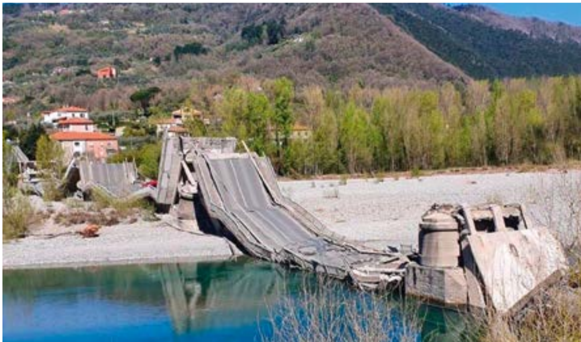
Il ponte di Albiano, sulla Statale 62, è crollato lo scorso 8 aprile causando solo due feriti lievi. Al momento si stanno svolgendo le indagini. Il ponte è stato costruito da Anas nel 1908. Distrutto durante la Seconda Guerra Mondiale, è stato ricostruito nel 1949. Nel corso degli anni, la gestione del ponte è passata poi dalla Prov. di Massa Carrara, fino al 2018, anno in cui è stata ripresa da Anas.
