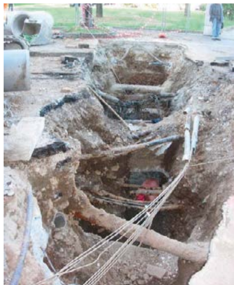
FIG 3. Situazione caotica di utility e infrastrutture a seguito di uno scavo in trincea
